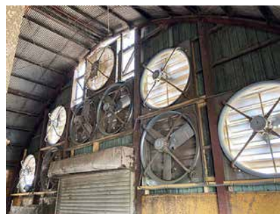
写真③ 換気扇の増設
